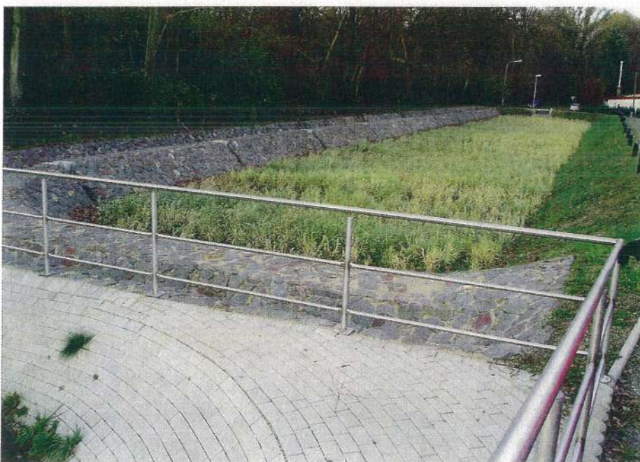
Abbildung 4: Retentionsbodenfilter nach einer Betriebszeit von ca. einem Jahr nach der Schilfpflanzung.
